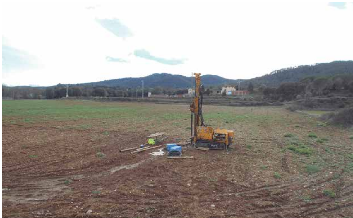
Realització d'un sondatge a Besalú amb la sonda Tecoinsa TP50-D per a la construcció d'una nau de 55.000 metres quadrats.
