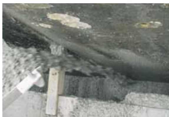
Foto 7: Vessament en un mur de formigó autocompactable amb fibres.
