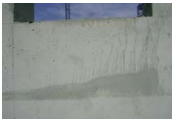
Foto 4: Rastre del talús natural del formigó.
