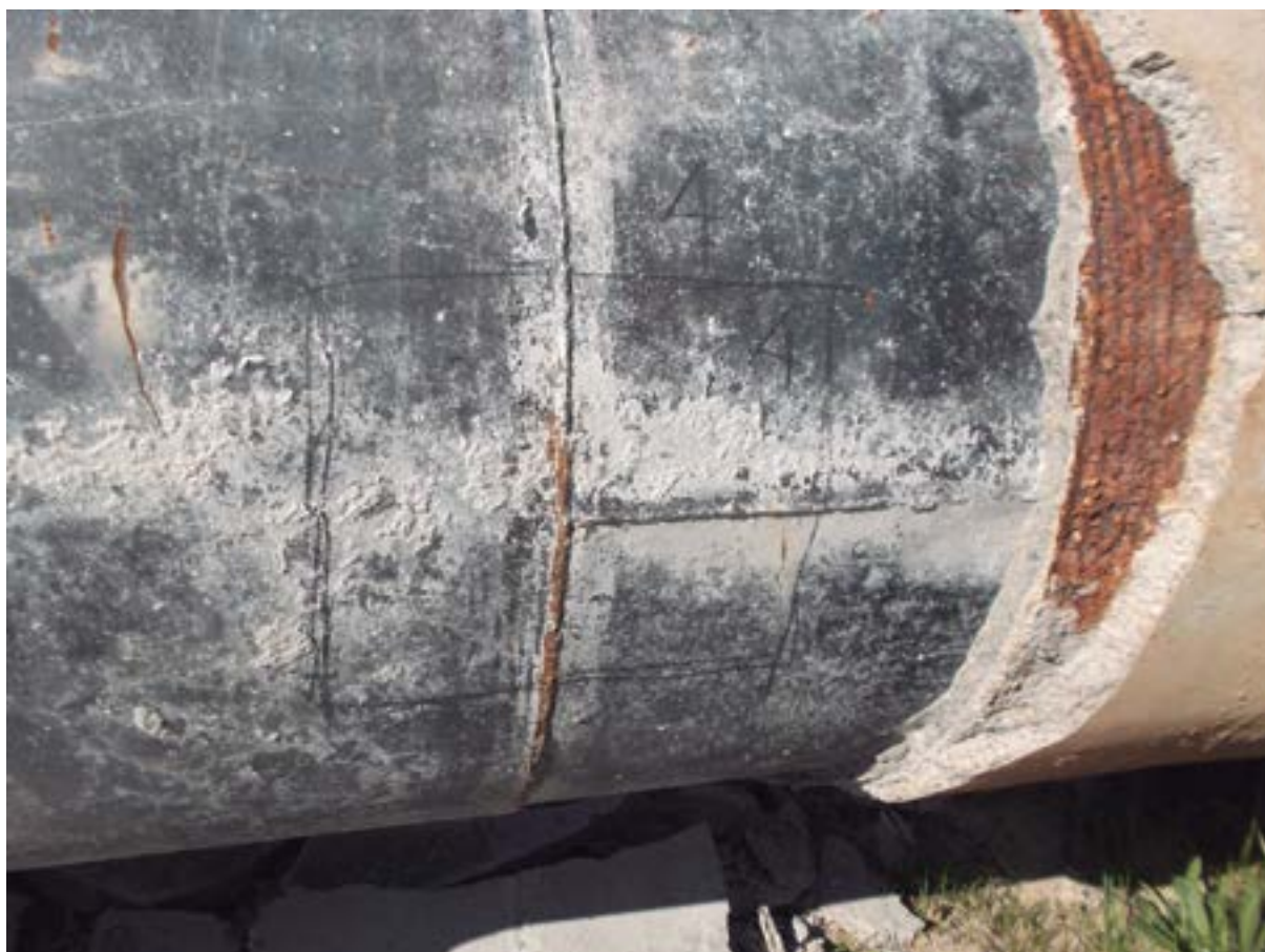
Estudi per a l'avaluació de les causes que han provocat el trencament d'una conducció d'aigua.
