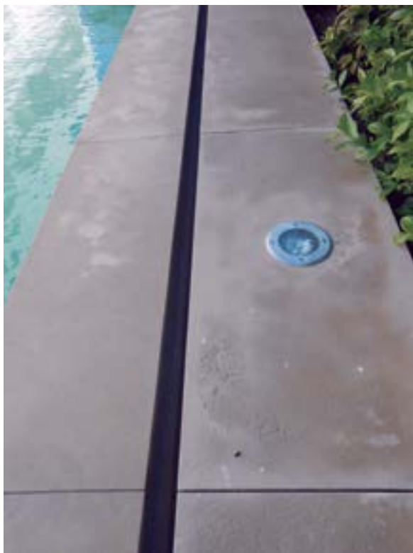
Avaluació del paviment de pedra natural d'una piscina.
