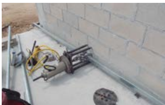
Adherència estructura suport de façana.
