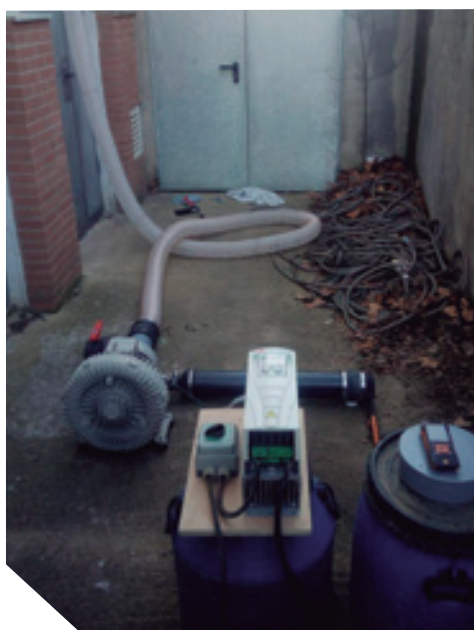
Proves de sala de calderes
